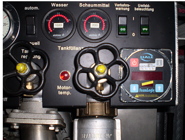
Fotografía 1: Bomba y consola de control para el inyector de humectante
